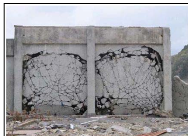
津波で破壊されたコンクリート壁
