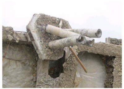
引きちぎられた基礎くい
