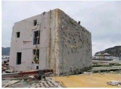
津波で転倒したRC建物
