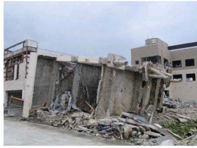
津波で転倒したRC建物
